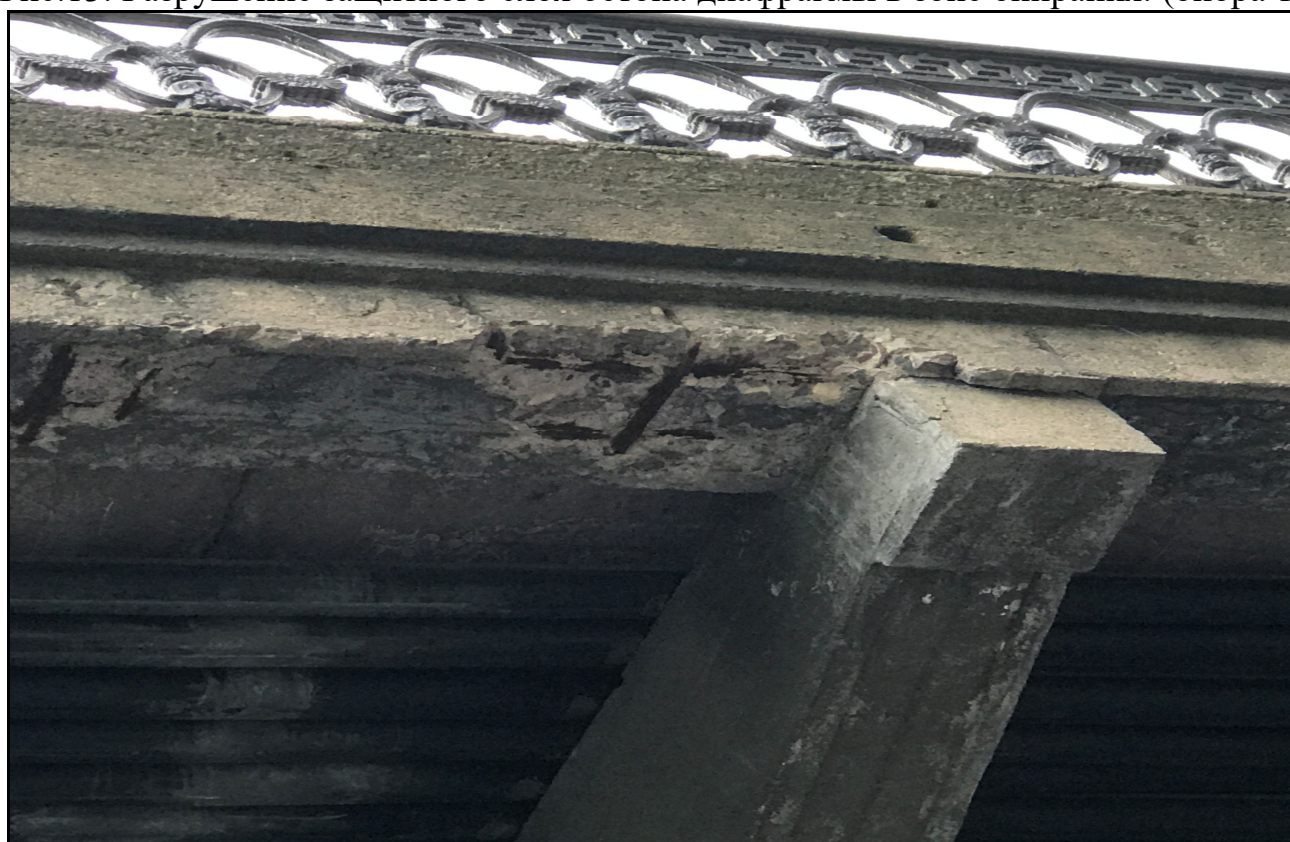
Рис.14. Разрушение бетона продольной балки тротуара.
