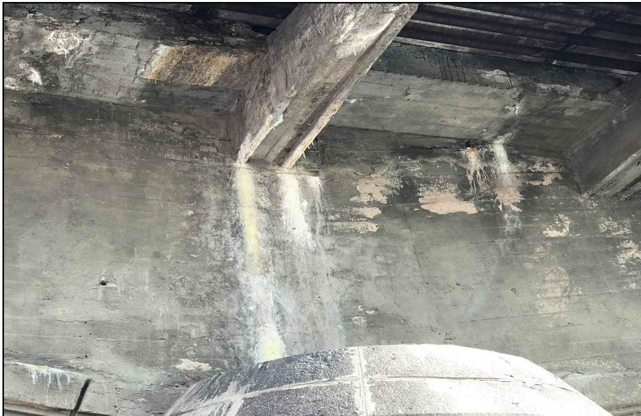
Рис.20. Протечки, выщелачивание по фасаду пролетного строения. (у опоры 1)
