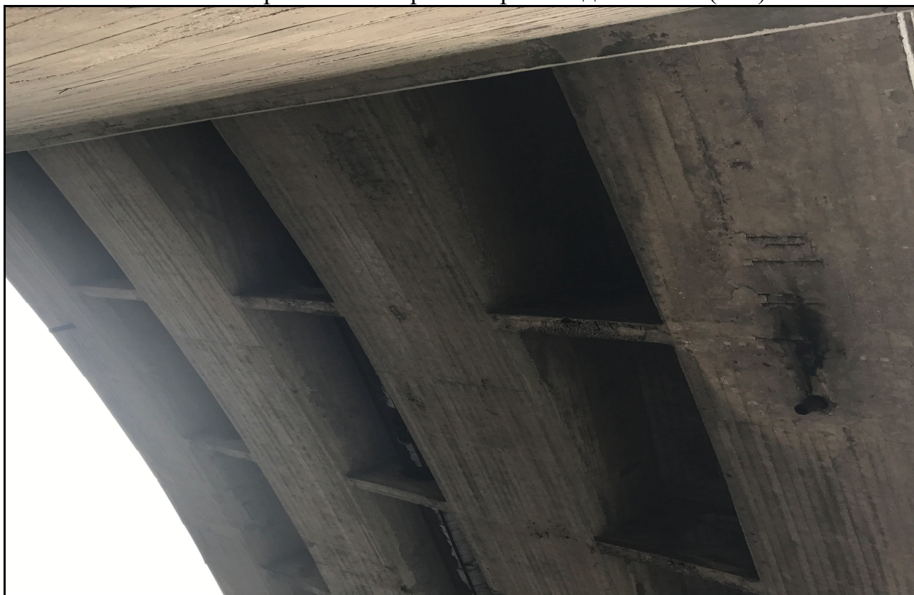
Рис.10. Протечки воды, отслоение защитного слоя бетона, коррозия арматуры в зоне водопропускных трубок. (Балка 4, у опоры 1).
