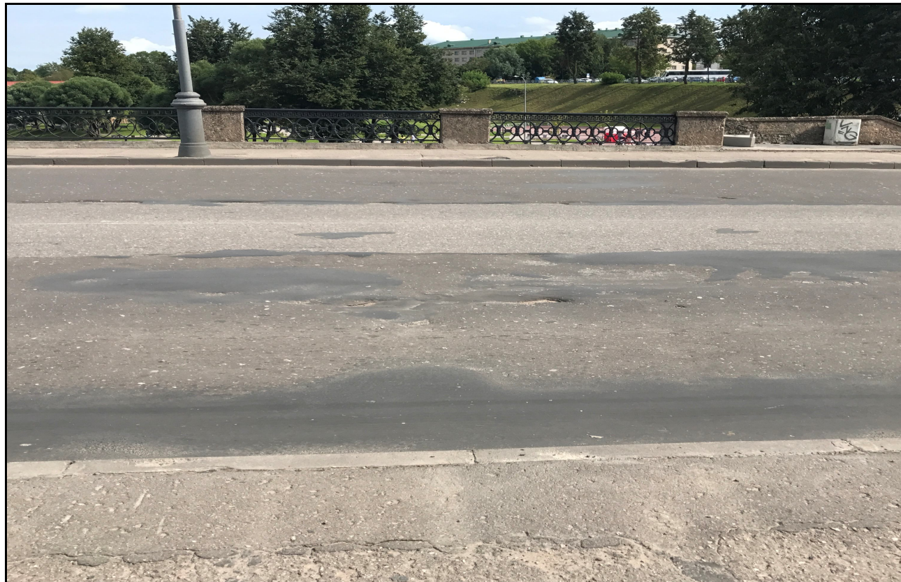
Рис. 16. Выбоины в покрытии.
