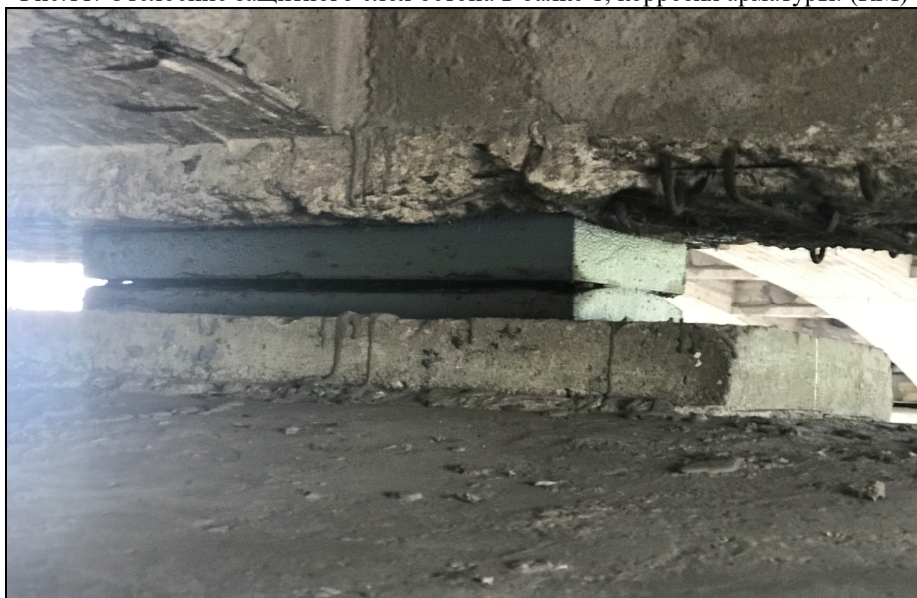
Рис.12. Разрушение защитного слоя бетона диафрагмы в зоне опирания. (опора 1)
