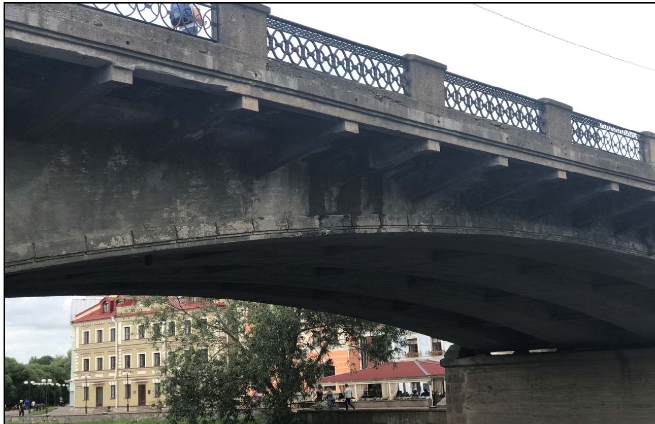
Рис. 18. Выщелачивание, мокрые следы протечек по фасаду.
