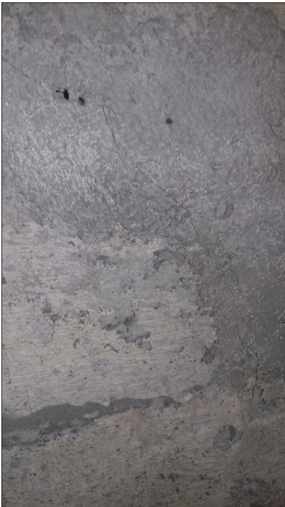
Рис. 29. Раскрытие силовой трещины в цементной затирке.
