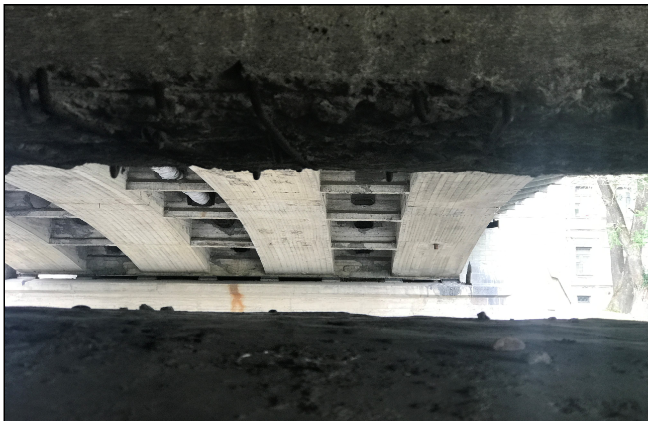
Рис.13. Разрушение защитного слоя бетона диафрагмы в зоне опирания. (опора 1)
