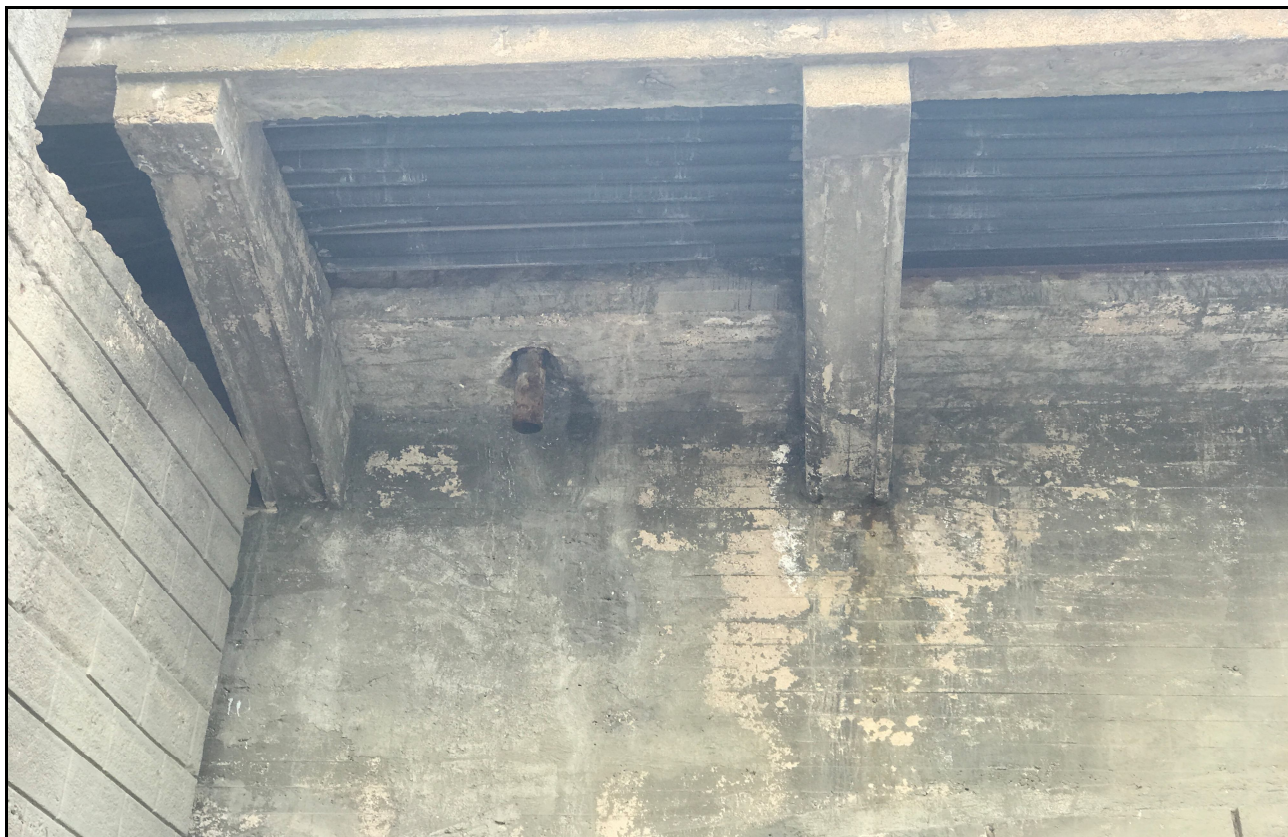
Рис. 19. Следы выщелачивания по фасаду.
