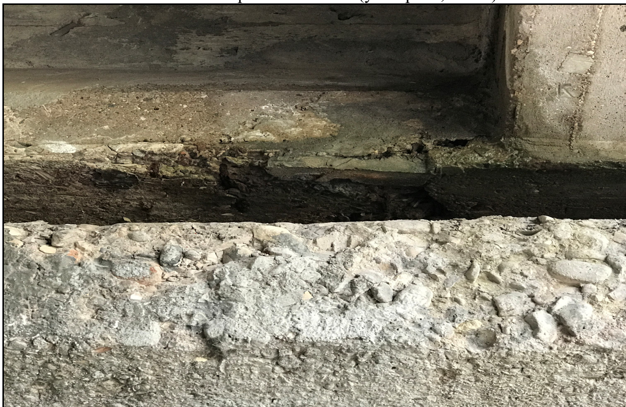
Рис.22. Разрушение бетона возле соединения стенки балки и диафрагмы.(подконсольная стенка в КМ)
