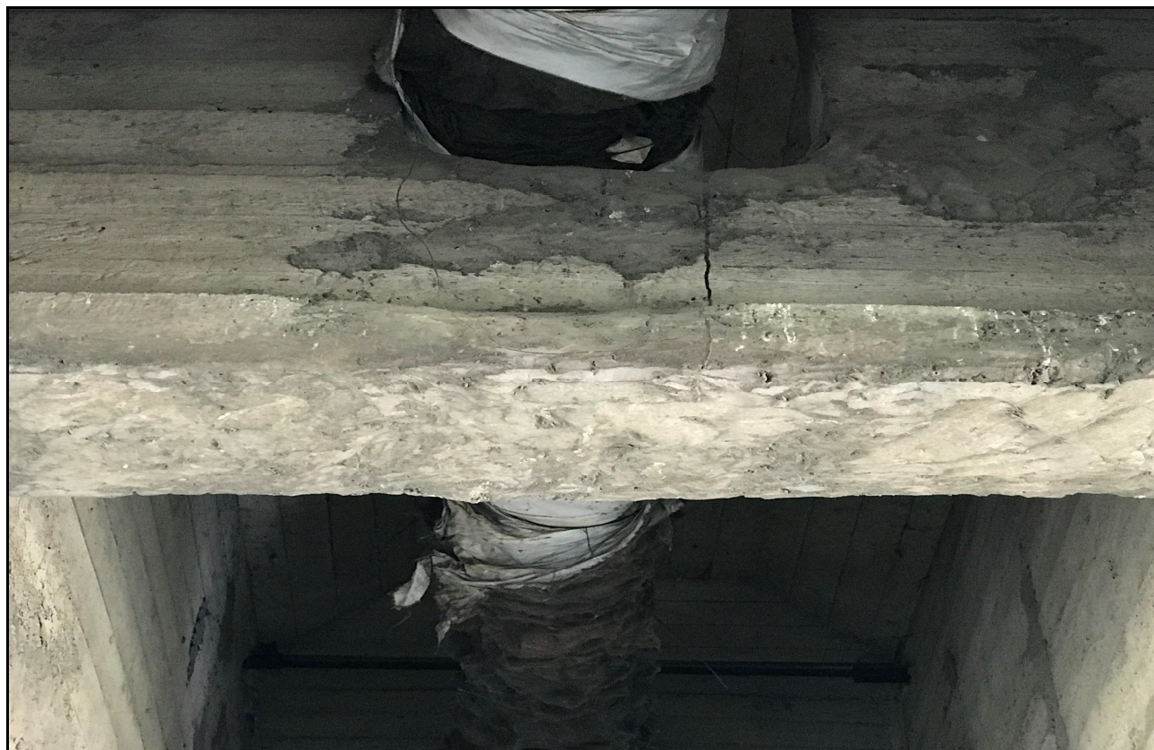
Рис.23. Поперечная трещина в диафрагме 6, между балок 2 и 3.
