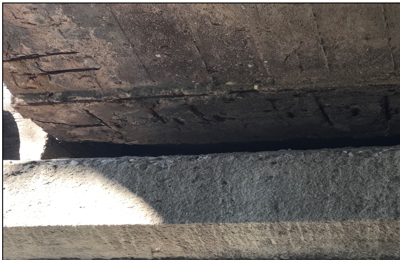
Рис.11. Отслоение защитного слоя бетона в балке 1, коррозия арматуры. (КМ)
