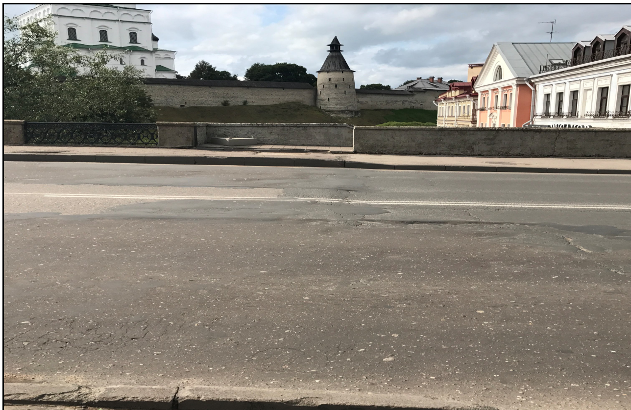
Рис.9. Образование порожка при въезде на мост (КМ)
