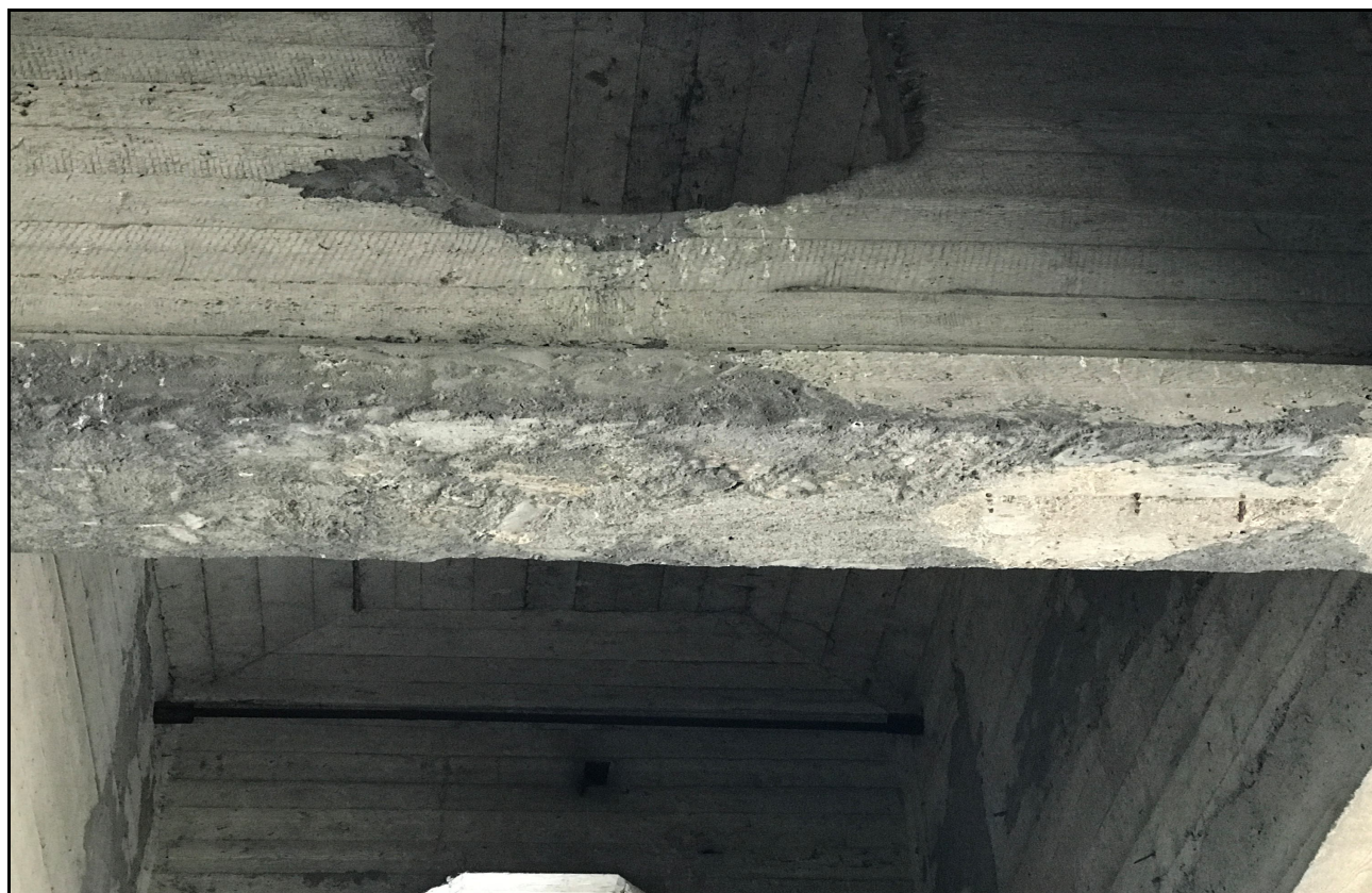
Рис. 17. Трещина в диафрагме. ( консоль в КМ, между балок 1,2)
