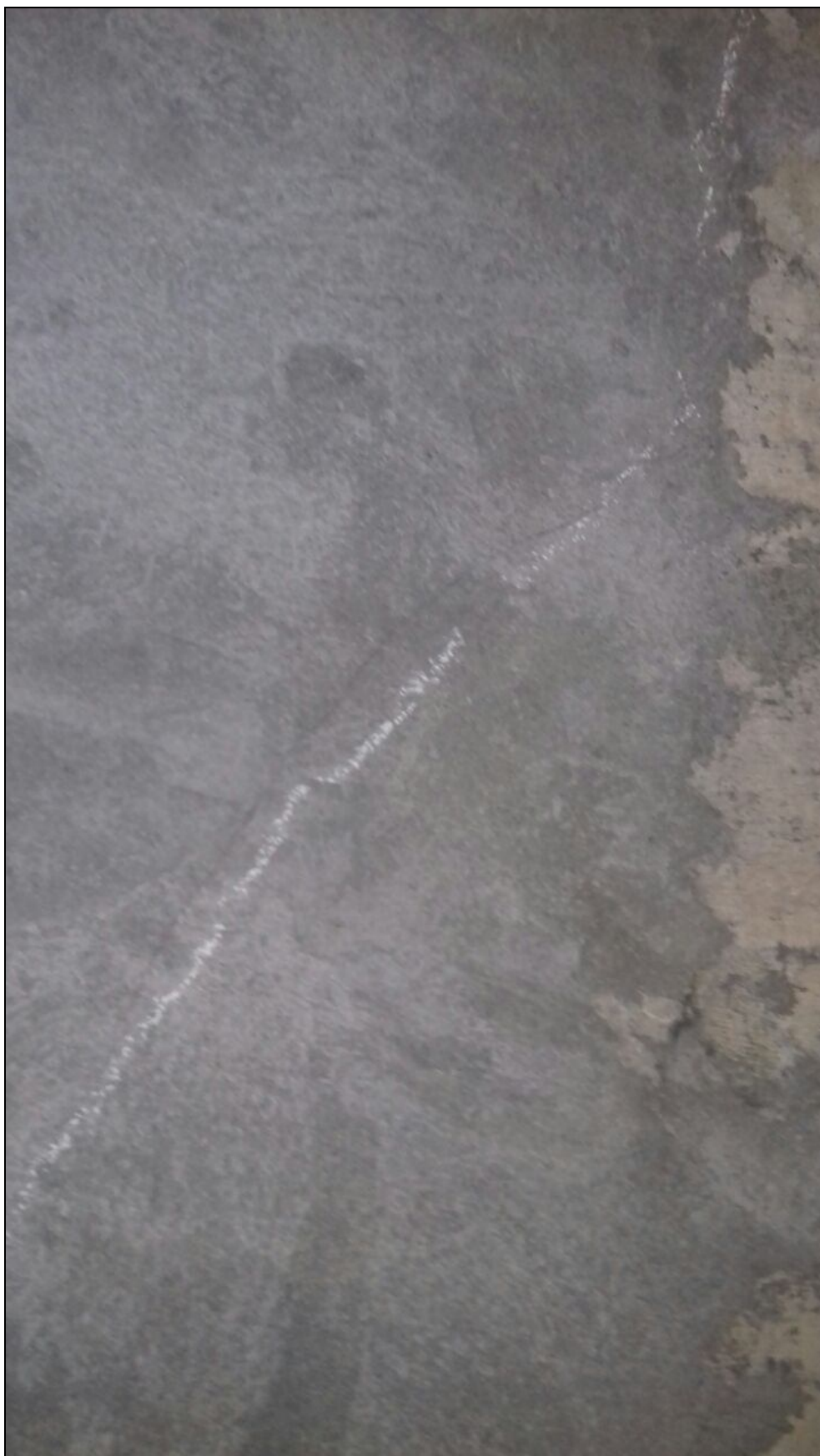
Рис. 28. Раскрытие силовой трещины в цементной затирке.
