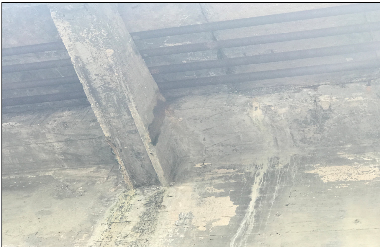
Рис.21. Следы протечек, выщелачивание, разрушение защитного слоя бетона консоли плиты проезжей части. (у опоры 1, слева)
